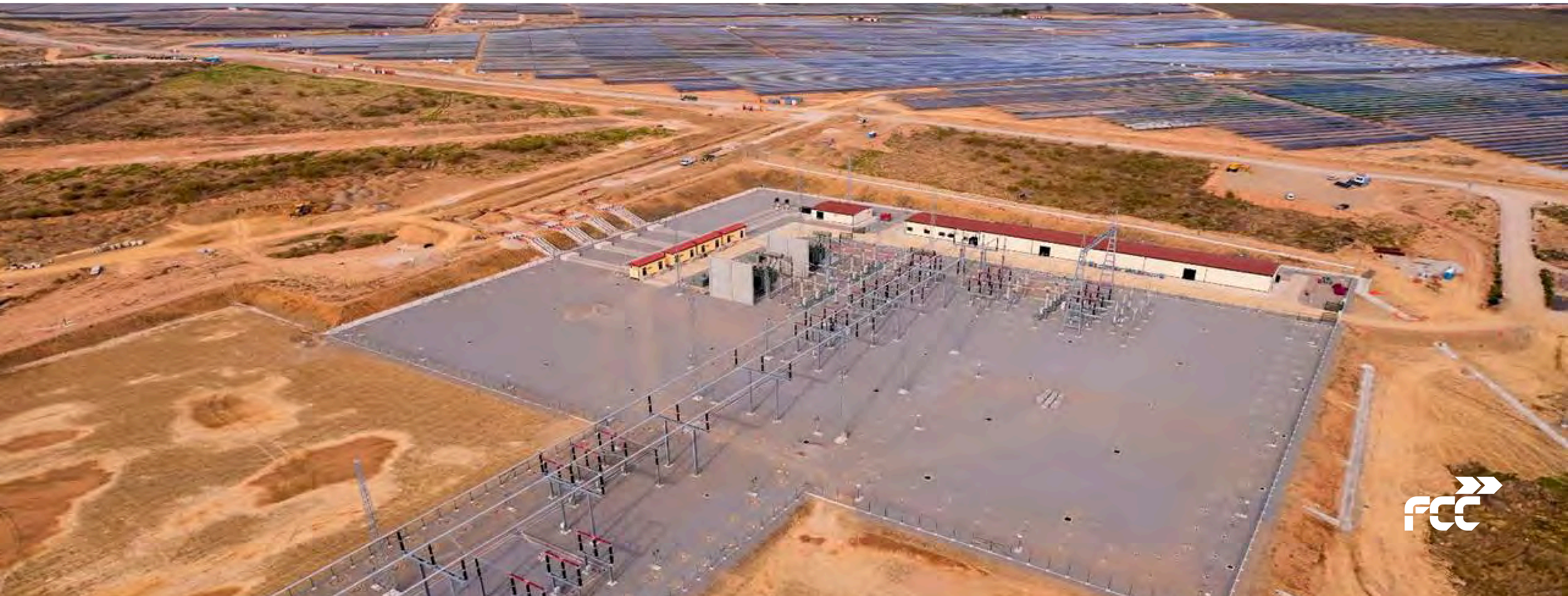
Planta fotovoltaica Pizarro, España
