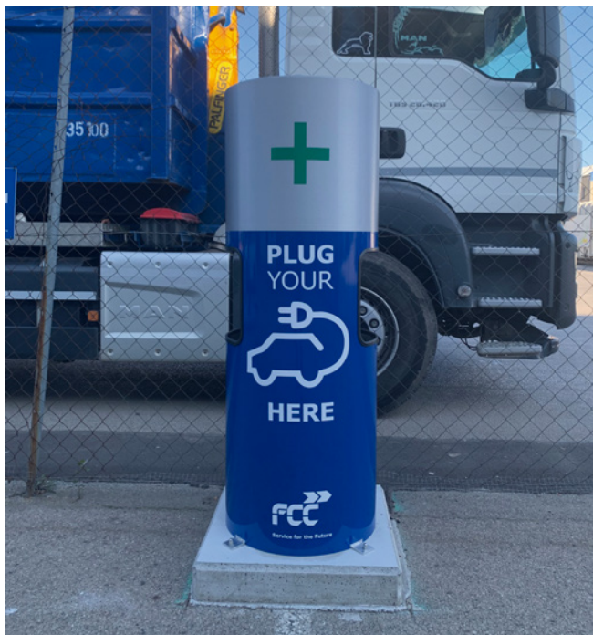
Estación de carga eléctrica Himberg (Austria).
