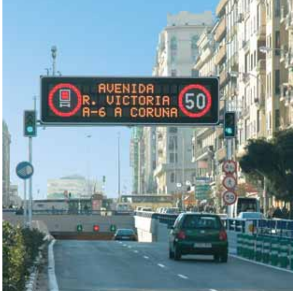
Traffic control system for Cuatro Caminos tunnel. Madrid
