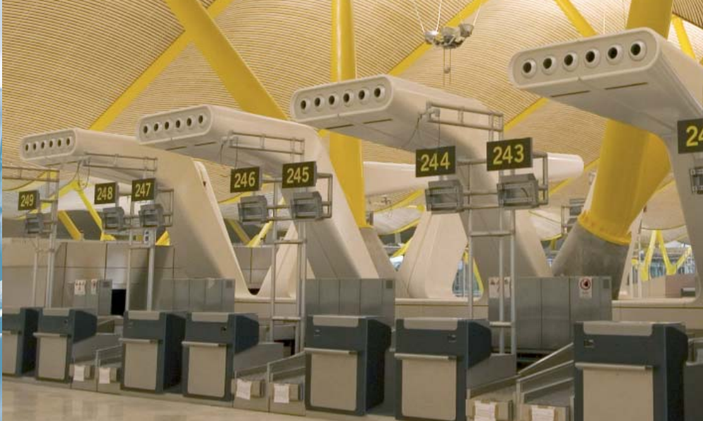
Climatización de la terminal 4 del aeropuerto Madrid-Barajas
