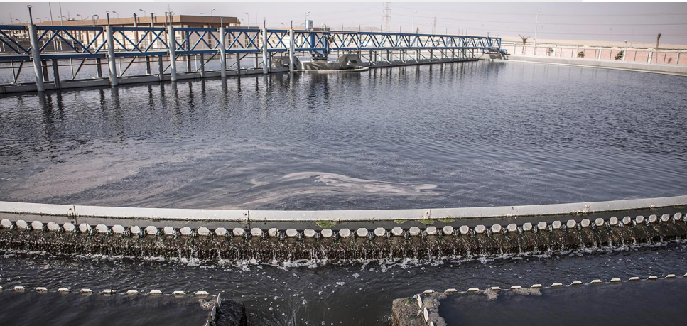
Depuradora New Cairo (Egipto).
